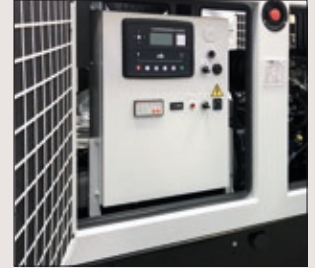
QUADRO CON CENTRALINA AGGIUNTIVA DI EMERGENZA CONTROL PANEL WITH BACK UP CONTROLLER
