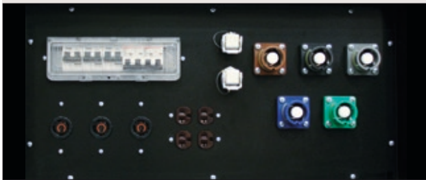
QUADRI DI DISTRIBUZIONE CON CONNETTORI 250/400/650A DISTRIBUTION PANEL WITH 250/400/650A CONNECTORS
