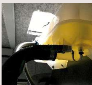
ALLARME LIVELLO LIQUIDO REFRIGERANTE WATER LEVEL ALARM
