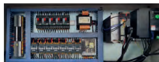
Quadro elettrico con componentistica Schneider
