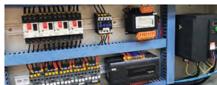
Quadro elettrico con componentistica Schneider
