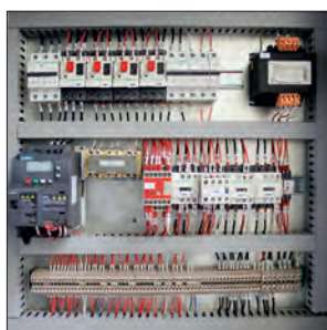
Quadro elettrico chiaro con cablaggi tramite connettori
