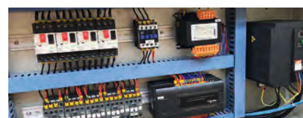
Quadro elettrico con componentistica Schneider
