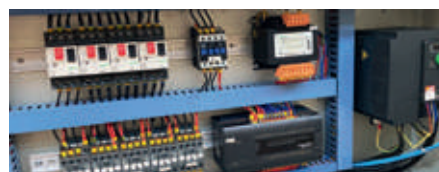
Quadro elettrico con componentistica Schneider
